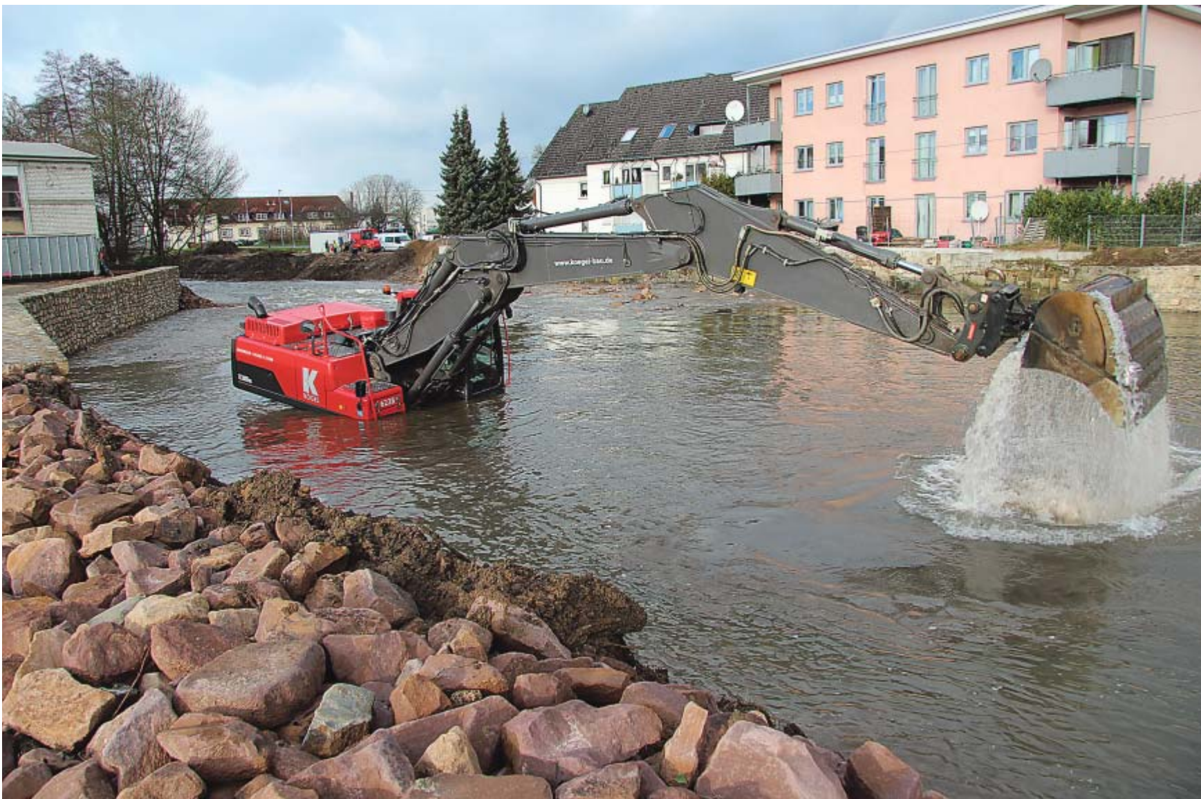
Bagger im Flussbett: Auch in Lemgo ist die Bega aufwendig renaturiert worden.
