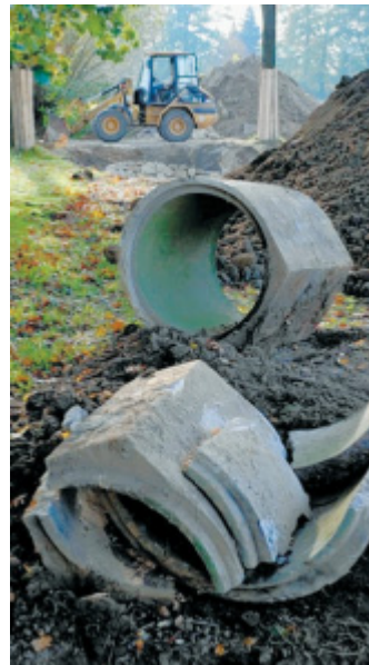
Zerborsten: Durch diese Betonröhren rauschte jahrzehntelang der Eilshauser Bach.
