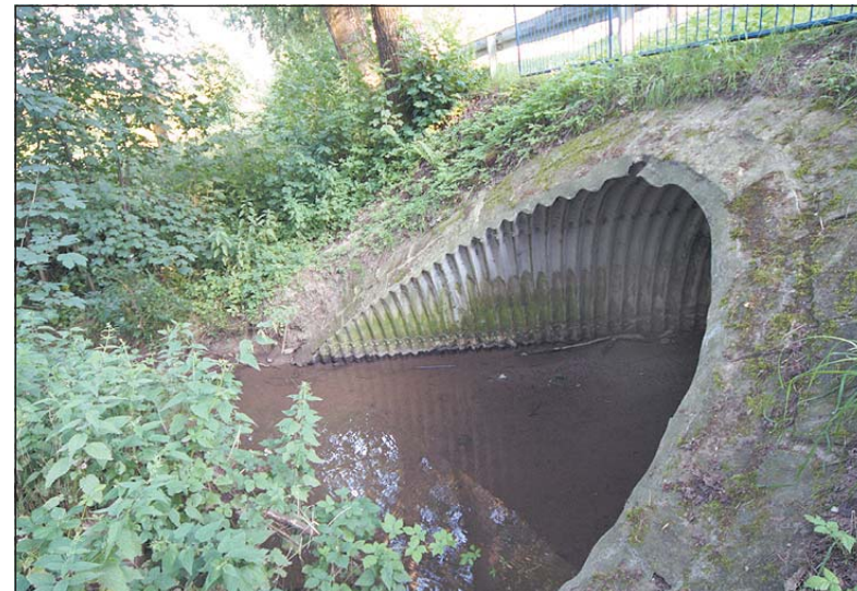
Der Hamco-Durchlass an der Diemker Straße leitet das Gros der Wasserfluten zum Wiesengrund. Fotos: Gerhard Hülsegge
