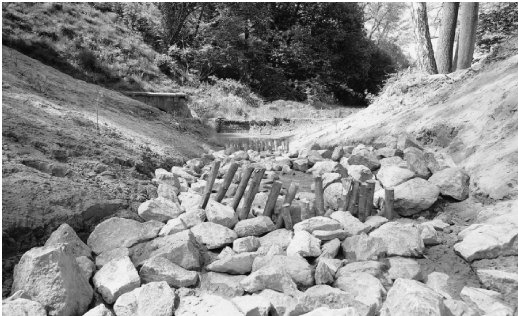
Ende Juni heißt es „Wasser marsch“: Mitarbeiter von „Maßarbeit“ haben im Naturschutzgebiet „Ziegeleigrube Ennigloh“ bereits Sohlgleiten angelegt, um die Höhenunterschiede für den Bach auszugleichen.
