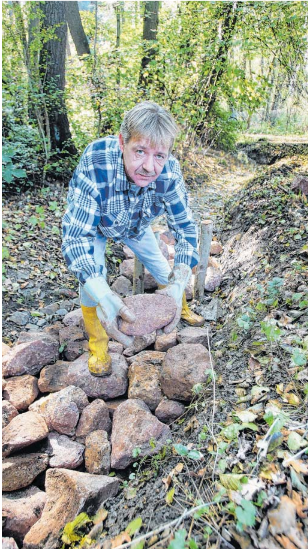
Puzzlearbeit: Jens Conrad von Maßarbeit verlegt Quarzsandsteine im Bett von Ellersieks Bach, um die Sohle anzuheben. Darauf wird eine Ton-Mergel-Mischung ausgebreitet. FOTOS: FRANK-MICHAEL KIEL-STEINKAMP
