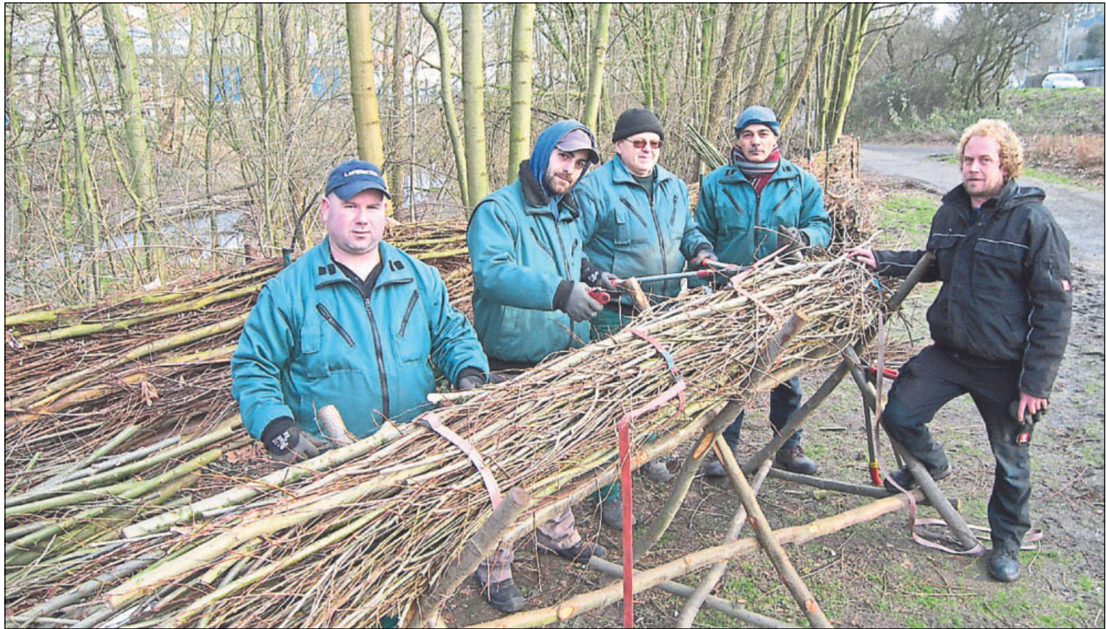
Neben dem Radweg unterhalb der Herforder Straße werden sogenannte Faschinen für Naturzäune aus Weidenruten gebunden: Gärtner Sven
