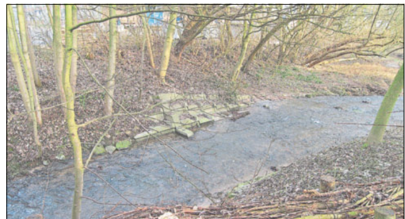
Reste von Betonsteinen erinnern an den einstigen Beckenrand des tiefer liegenden Sandfangs für den früher eingezwängten Forellenbach.
