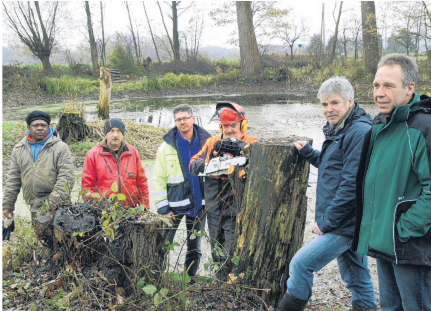
Die Motorsäge dröhnt: Komi N'Sougan, Ralf Iwer, Heinrich Linnert und Thomas Kränke vom Weser-Werre-Else-Gewässerentwicklungsprojekt besprechen mit Klaus Kernebeck und Heiko Eggert (v.l.) den Fortgang der laufenden Arbeiten.
